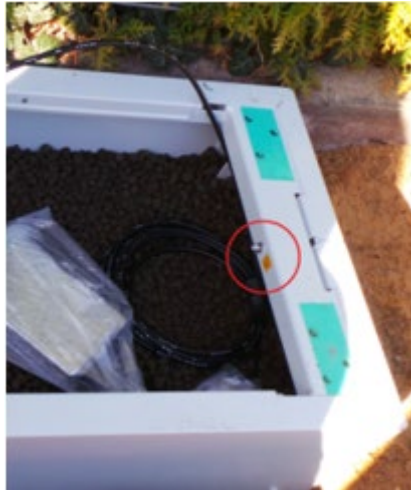
Abbildung 57: Erdungspunkt für provisorische Erdung
